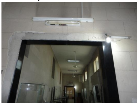
الصورة (٩٣): تظهر التآكل في المنحور الخشبي للباب-المصدر: الباحثة.
