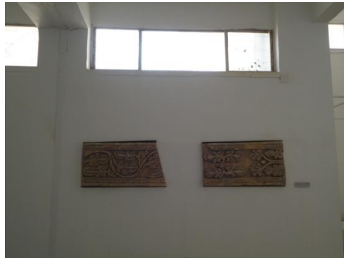
الصورة (١٤٤): تظهر الوهج والسطوع المبهر بسبب عدم معالجة النوافذ - المصدر: الباحثة.
