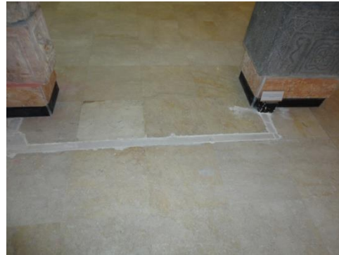
الصورة (١٢٤): الأرضية في صالة الفن الكلاسيكي: تظهر فيها آثار التمديدات الكهربائية، مما أدى إلى تشويه في شكلها -المصدر: الباحثة.
