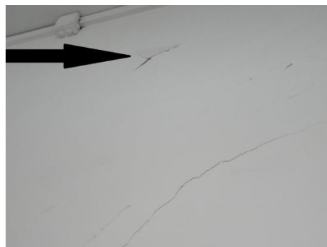
الصورة (٩٢): تظهر تشققات في دهان الجدران-المصدر: الباحثة.
