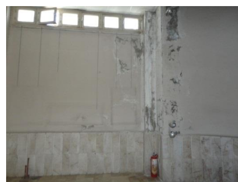
الصورة (١٥٨): أثر الرطوبة على الجدران -المصدر: الباحثة
